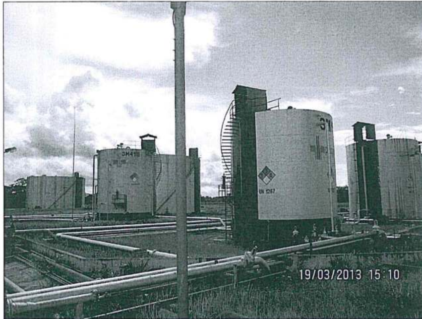
FOTOGRAFÍA N° 10: Vista del área estanca de los tanques de almacenamiento de hidrocarburos de la Baterías 1, no se encuentra impermeabilizada. se observa suelo con cobertura vegetal.
