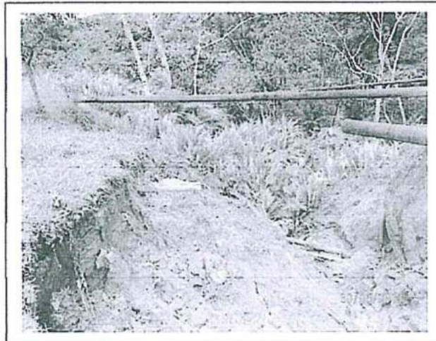
Fotografía N° 53: En Jibaro Isla (Coordenadas UTM, Sistema WGS 84: 0383936E, 9700744N) se observó el deslizamiento del talud de la plataforma, poniendo en riesgo la estabilidad de las tuberías de la línea de flujo (crudo y diesel).
