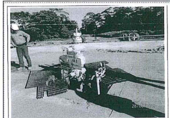
Fotografía N° 15: Pozo CN 2 (Coordenadas UTM, Sistema WGS 84: 0332417E, 9705177N) se observó la cantina del Pozo deteriorada, la misma que deberán ser mantenidas.
