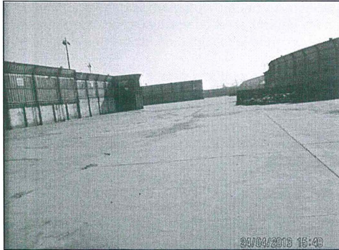
Fotografía N° 12 del Informe de Supervisión: Patio de concentrados donde se observa que no hay techo encierro como indica la etapa de adecuación del depósito de almacenamiento, según el cronograma establecido en el EIA de Neptunia.
