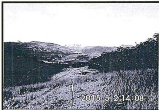
Foto N° 04: Vista Panorámica del KP 183+644 y DDV afectado, la misma que se ha construido sobre ladera. El LGN drena hacia la quebrada Qachqarumi luego a la quebrada Huayrapata que discurre casi paralelo al DDV. La línea roja punteada demarca la zona afectada por el derrame de LGN (4080m 2 ). Coordenada UTM: 0656041E, 8570198N
