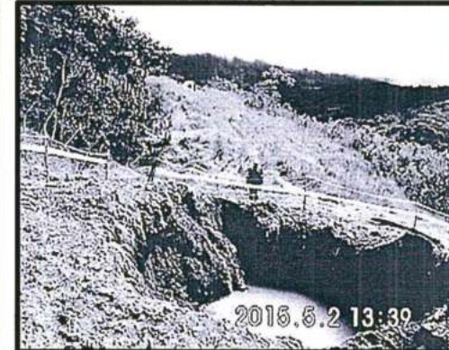
Foto N° 7: KP 183+644 cráter de 5m de diámetro formado por la falla del ducto. Se observa el LGN en un nivel por sobre encima del ducto de 14°. De esta manera el ducto no es posible de observar. Los trabajos de reparación de la sección de ducto dañado se afectarán a partir del día 03.05.2015. (Coordenada UTM WGS84: 0656041E, 8570198N)
