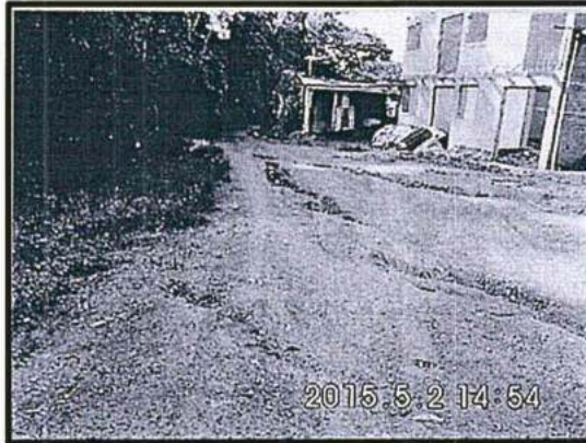
Foto N° 02: Acceso inicial al punto de falla del ducto de LGN. Sobre el acceso se observa grandes grietas que atraviesan el ancho del acceso. Coordenada UTM (WGS84): 656078E, 8569061N
