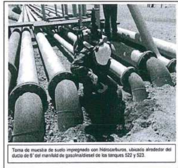
Vista del suelo impregnado con hidrocarburos ubicado alrededor del ducto de 6" del manifold de gasolina/diésel de los tanques 522 y 523. (Área 0.09 m 2 ).
