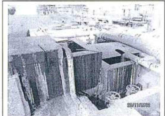
Fotografía N° 8: Se puede apreciar, el área del manifold de ingreso de crudo, la misma que se encuentra impregnado con hidrocarburo.
