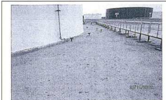
Fotografía N° 21: Se puede apreciar el suelo del área estanca de tanque 557, que se encuentra sin impermeabilizar.
