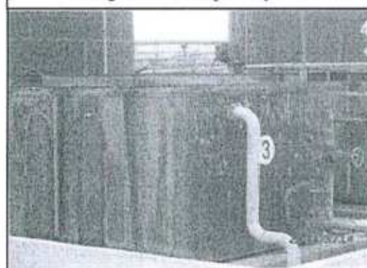
Fotografía N° 2 - Cajas Slop N° 3
