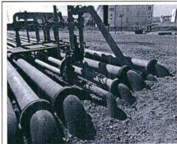
Vista de área rehabilitada donde hubo suelo impregnado con hidrocarburos, ubicado alrededor del ducto de 6" del manifold de gasolina/diésel de los tanques 522 y 523.
