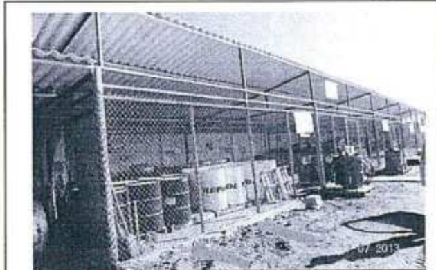
Fotografía N°24: Almacén temporal de lubricantes, 45 cilindros conteniendo lubricantes, sobre losa de concreto sin doble contención, no se muestra protección contra derrames y se almacena muy próxima al suelo natural.
