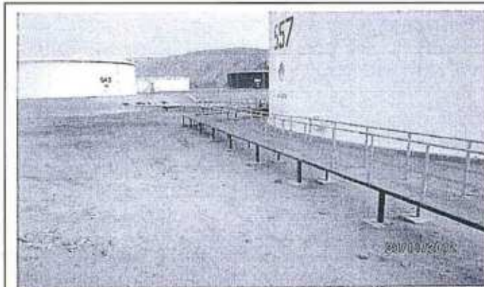
Fotografía N° 20: Se muestra el área estaca del tanque 557, el mismo que no se encuentra impermeabilizado.
