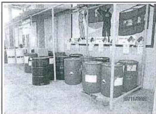
Fotografía N° 18: Se muestra el área donde se viene almacenando productos químicos y combustibles, sobre un área que no cuenta con barrera de doble contención.
