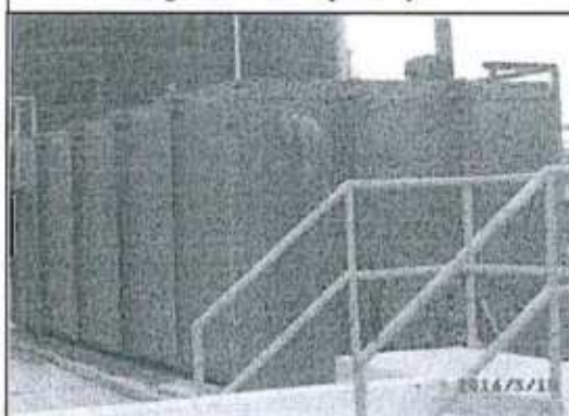
Fotografía N° 1 - Cajas Slop N° 1
