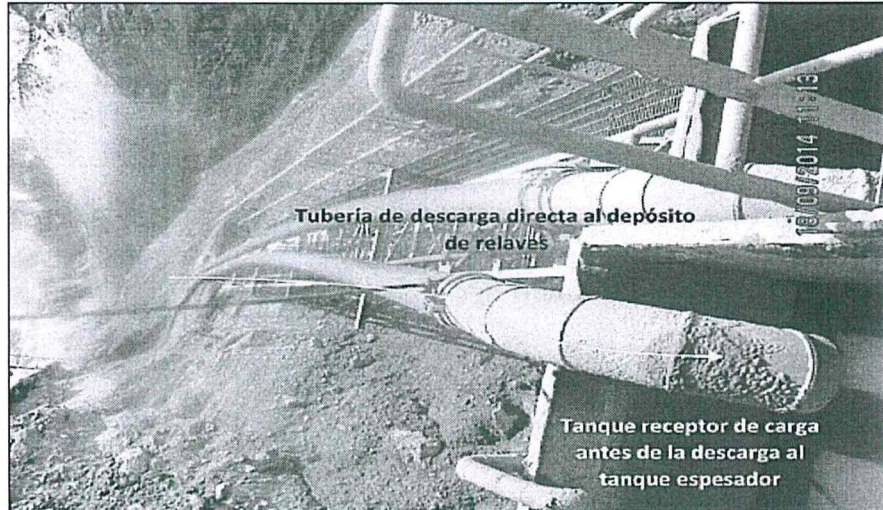
Fotografía N° 31.- Vista de la descarga de relaves de la tubería HPDE al tanque espesador (uno va al tanque y el otro es para descarga directa a la lavera)
