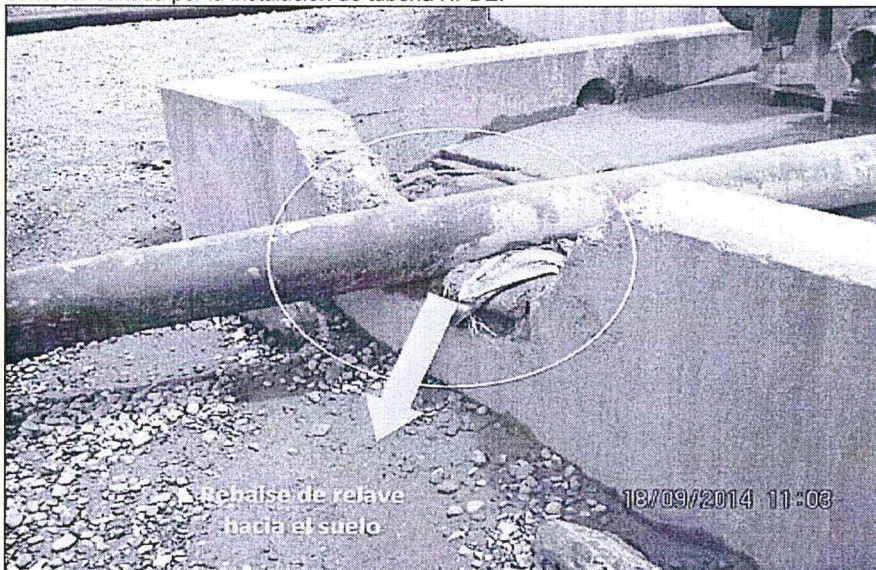
Fotografía N° 35.- Se puede apreciar rebalse de relave sobre el suelo.
