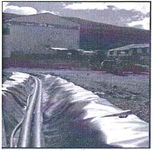
Tuberías desde la Planta Concentradora hasta el Tanque Espesador.
