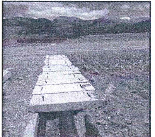
Tubería de relaves en la salida del Tanque Espesador a relavera por ducto de concreto.
