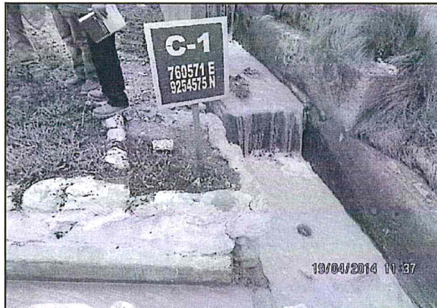
Fotografía N° 5 del Informe N° 738-2014-OEFA/DS-MIN.- Punto de monitoreo C-1 de la descarga de la planta de tratamiento de aguas residuales al canal Sinchao.
