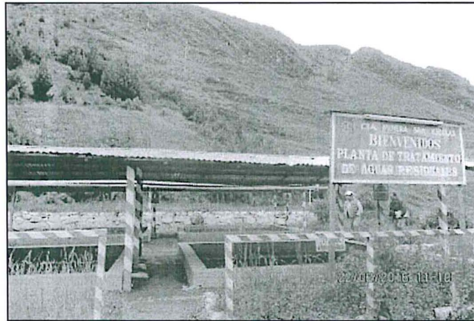
Fotografía N° 15 del Informe de Supervisión.- Sistema de tratamiento de aguas residuales, en esta planta descargan las aguas provenientes del canal San Nicolás. Coordenadas UTM WGS84: 9254189N, 760292E, Zona 17 S.
