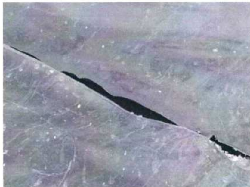
Fotografía N° 52: Vista fotográfica de la roturas en la geomembrana del pad de lixiviación. El pad de lixiviación, las pozas de solución barren y de grandes eventos en la zona de San Nicolás no cuentan con piezómetros para el control de aguas subterráneas. Adicionalmente se encontraron roturas en la geomembrana en algunos sectores en el borde del pad. Hallazgo N° 11.
