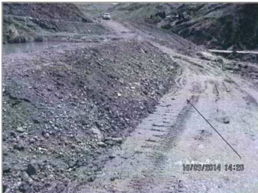
Fotografía N° 180: El tajo El Zorro cuenta con una poza para la acumulación de drenajes en terreno natural, dicha poza presenta filtraciones que discurren hacia el depósito de desmontes en la parte inferior del tajo. Hallazgo N° 8.
