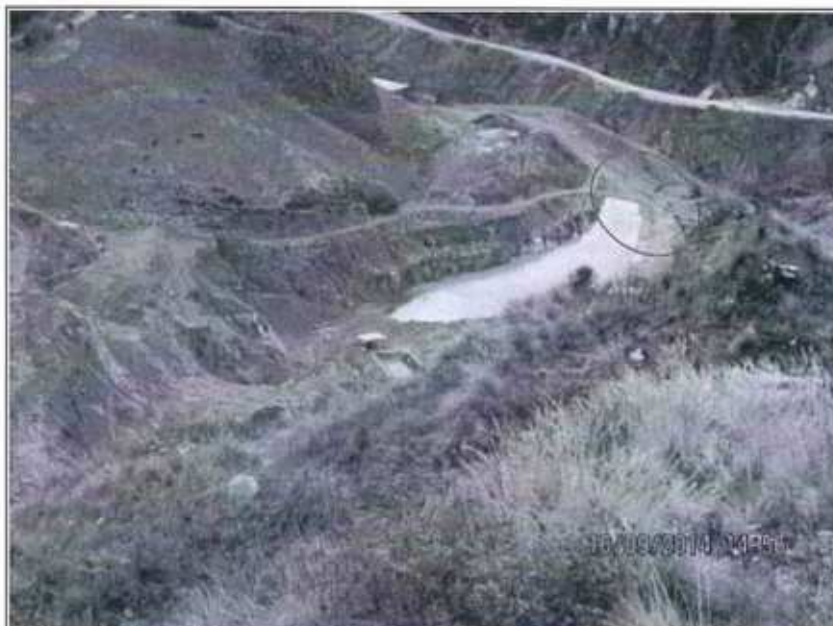
Fotografía N° 179: El tajo El Zorro cuenta con una poza para la acumulación de drenajes en terreno natural, dicha poza presenta filtraciones que discurren hacia el depósito de desmontes en la parte inferior del tajo. Hallazgo N° 8.
