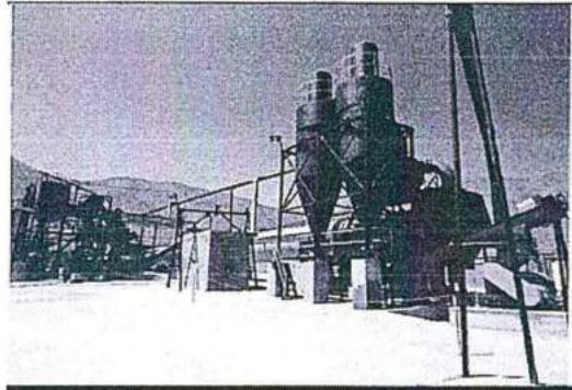
Foto N° 57: Vista de los ciclones del secador.
