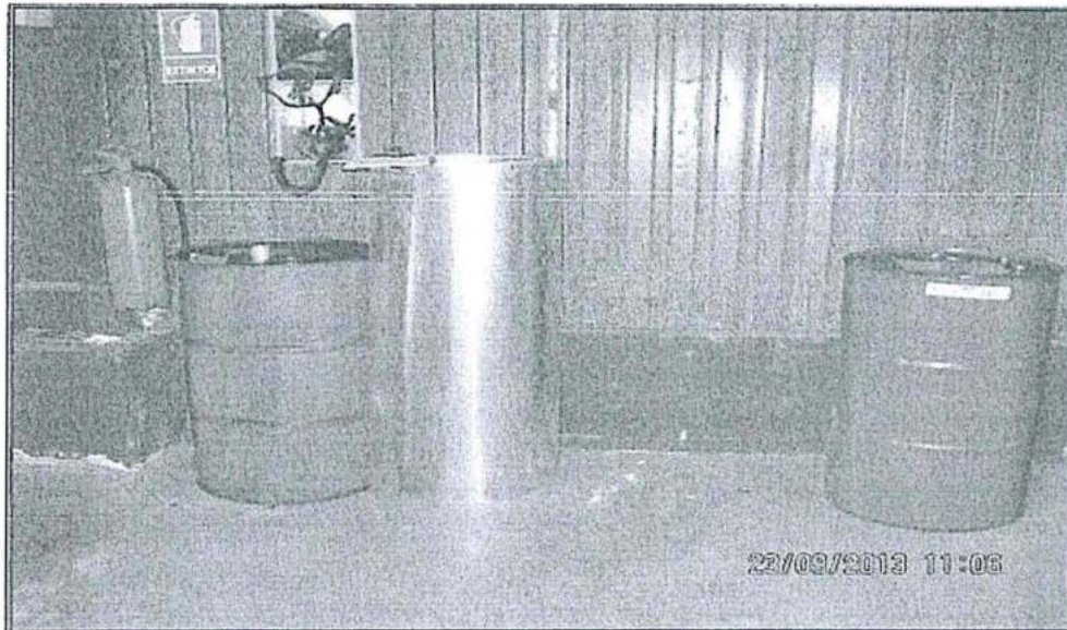
Foto 15. Cilindros con combustibles para la sala de compresores sin acondicionar (no existe almacén de residuos industriales peligrosos).
