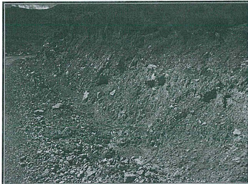
Fotografía N° 9: Hallazgo N° 5 Vista Fotográfica del sistema de contención (Barrera de sedimentación) de la vía de acceso en el sector Huacchara está colmatado.
