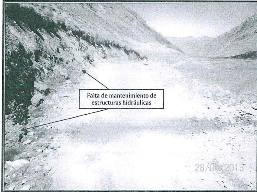
Fotografía N° 2: Hallazgo N° 1 Vías de acceso al campamento con falta de infraestructura hidráulica.
