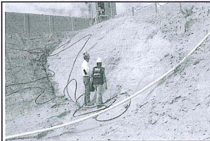
Fotografía N° 20 Zona de Talud parte interna de la Planta coordenadas UTM WGS 84 (N: 9501540 E: 474751) no se evidencia banquetas o terrazas escalonadas dentro de la Planta Criogénica Pariñas.
