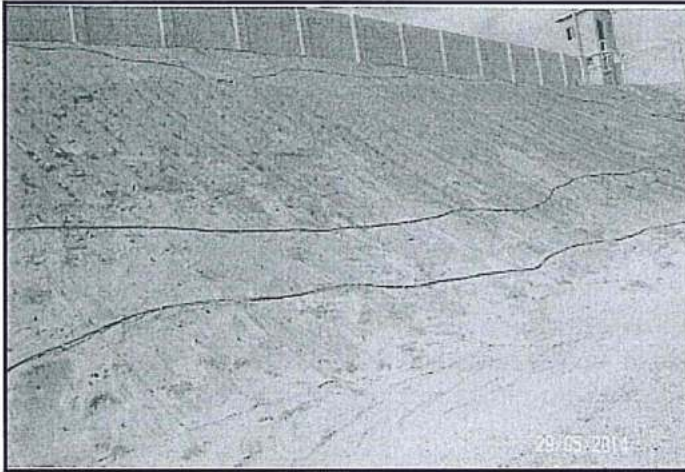
Fotografía N° 19 Zona de Talud parte interna de la Planta coordenadas UTM WGS 84 (N: 9501560 E: 474784) no se evidencia banquetas o terrazas escalonadas dentro de la Planta Criogénica Pariñas.
