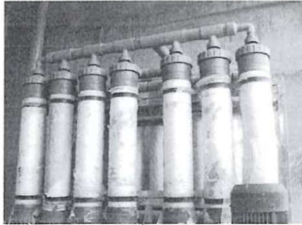
EQUIPO DE RECIRCULACION Y FILTRADO (14 FILTROS)
