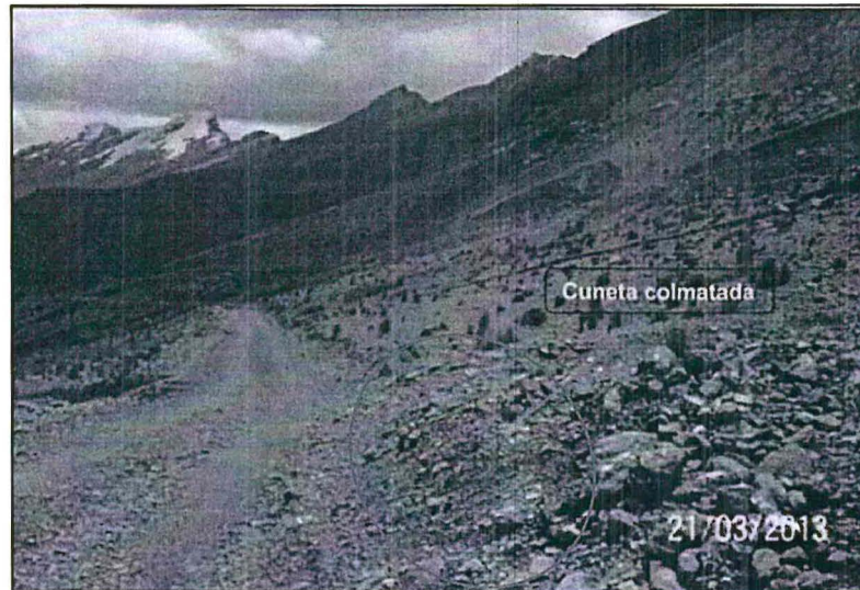
Fotografía ZN N° 3.- En el acceso principal a 400 metros antes del depósito de desmontes AN-DD-01, se observó un tramo de cuneta colmatada. Puntos de referencia: 8830328N y 312180E – 8830474N y 312180E.
