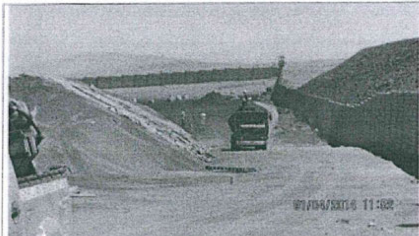
Foto N° 10: Se aprecia el desarrollo de regado de vías de tránsito interno, así como la impregnación del material particulado en la parte exterior del almacén de carbón y clinker (a).
