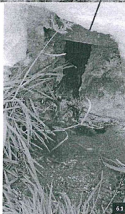
Foto N° 06: Forado en la pared externa a la altura de la ducha (6.1), se observa la salida de aguas residuales que se generan en la ducha y caño de lavado y descarga directamente sobre el suelo; apreciándose presencia de plantas que han crecido por la humedad que genera la descarga (6.2).
