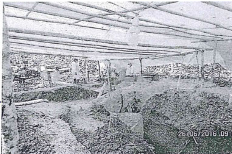
Zanja construida para ubicar el tubo que se encontraba enterrado a unos 2 metros de profundidad, aproximadamente. Coordenada 9468409N/309752.
