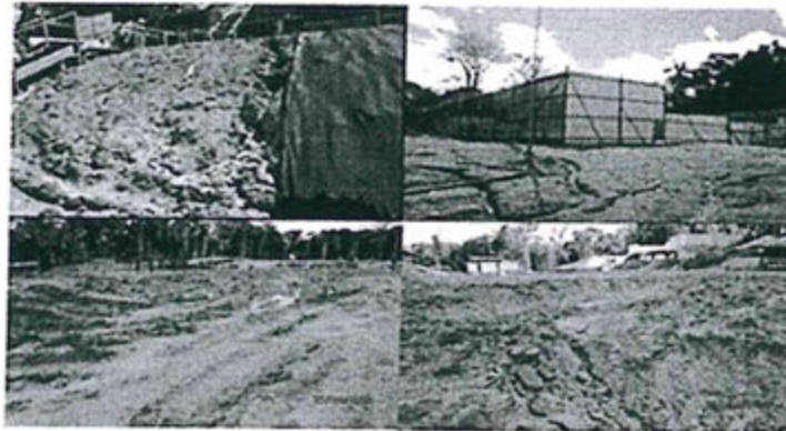
Fotografía N° 12: Erosión de suelos en la locación Colpa
