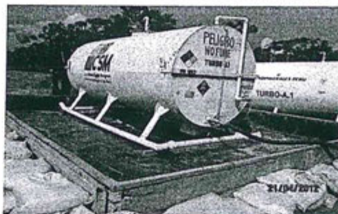
Fotografía N° 5: Almacén de combustibles C.B. Sheshea
