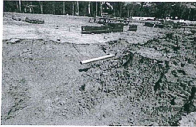
Fotografía N° 11: Erosión de suelos en la locación Colpa
