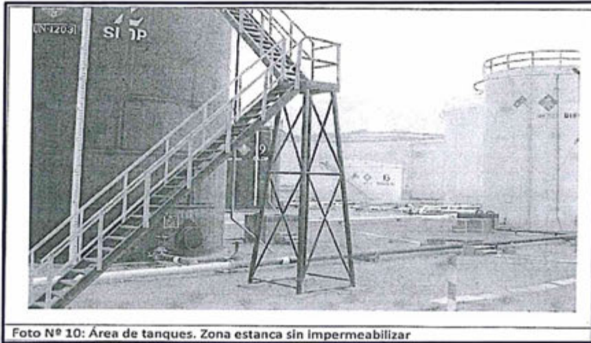
Foto N° 10: Área de tanques. Zona estancia sin impermeabilizar
