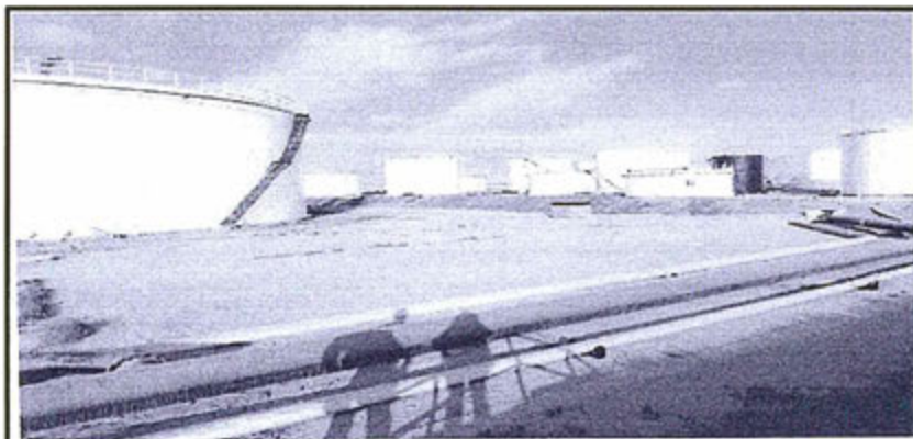
Fotografía N° 7: Área estancia 1 sin impermeabilizar. Se observan los tanques N° 3, 8, 12, 13, 15, 16, 17 y slop negro.
