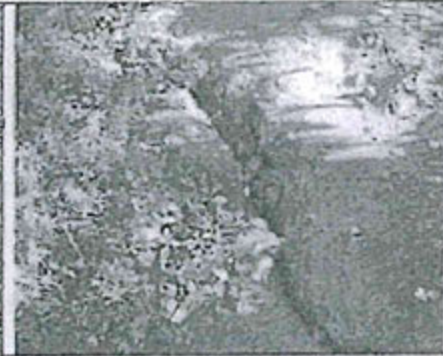
Vista 4. Suelo, con rajaduras longitudinales, encima de la perforación del túnel bocatoma Huaura - bocatoma Checras.
