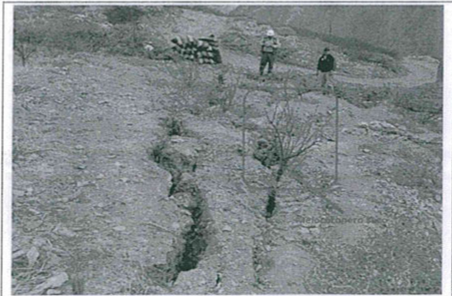
Fotografía N° 13. Cultivo de melocotoneros en abandono debido a las grietas
