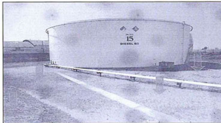
Área estanca y talud de dique de contención sin impermeabilizar, área estanca del patio de tanques N° 2
