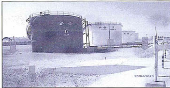
Área estanca y talud de dique de contención sin impermeabilizar, área estanca del patio de tanques N° 3
