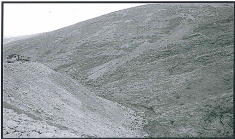
FOTO N° 20: Incumplimiento de Recomendación N° 6, 2010: Depósito de desmonte Nivel 600 (34), situado en la parte superior de las oficinas de la Unidad Minera, que actualmente se encuentra en uso, no cuenta con canales de coronación para las aguas de escorrentía.
