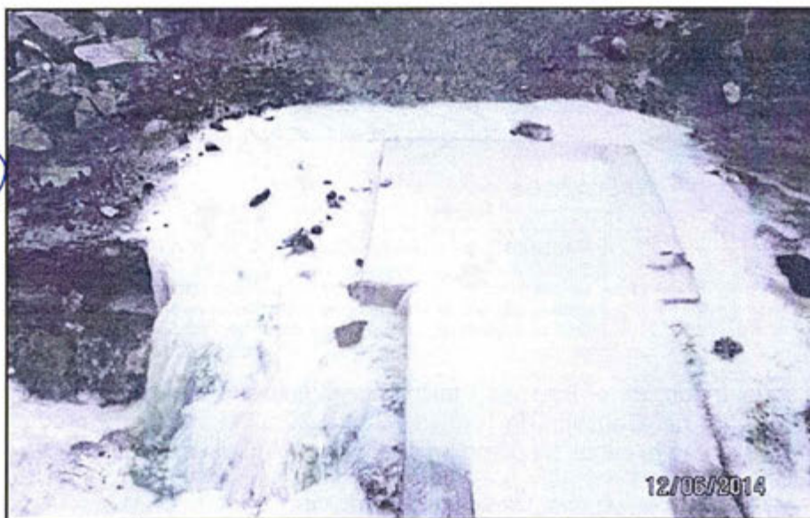
FOTOGRAFÍA N° 6.-. Rebose de las aguas provenientes del depósito de relaves Santa Catalina en la caja de conexión con las tuberías. Nótese el flujo de agua que ingresa a la quebrada Santa Catalina.
