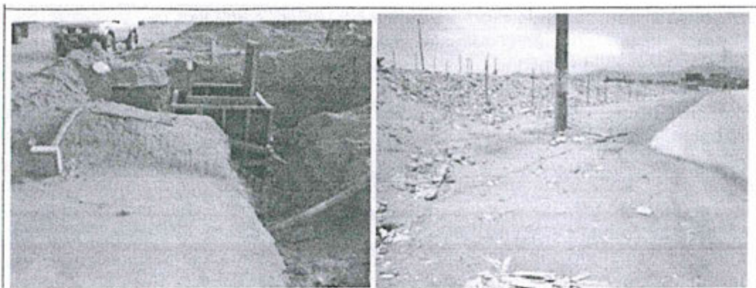
Vista 16. A la izquierda la situación observada, zanjas abiertas y sin señalización. A la derecha, situación actual, zanja cerrada.
