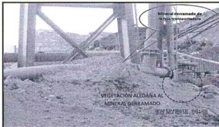
Foto N° 71: Observación N° 02-2012. Otro sector de los derrames producidos desde la faja transportadora sobre el suelo.
