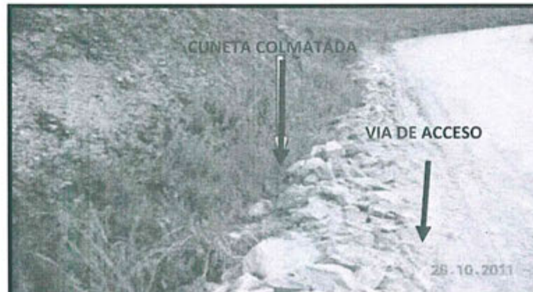
Fotografía N° 19: Cuneta de la vía de acceso hacia el lado NE del dique del Depósito de Relaves Las Águilas – Las Gordas, colmatado y sin mantenimiento correspondiente, Recomendación N° 8, UM Cerro Corona, 2011.
