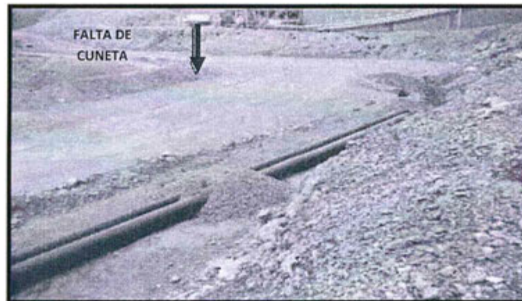
Fotografía N° 22: Vía de acceso Haul Road 2, no se observa las cunetas de drenaje correspondientes para escorrentías, Recomendación N° 8, UM Cerro Corona, 2011.
