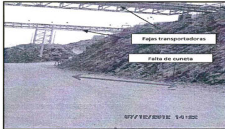
Foto N° 68: Observación N° 01-2012. Otra vista de la vía de acceso a la planta concentradora, donde el titular minero no ha implementado cunetas para la evacuación de las aguas de escorrentía.
