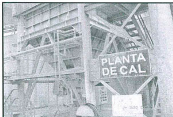
Foto N° 81: Observación N° 06-2012. Tolva de alimentación de cal, actualmente inoperativa.
