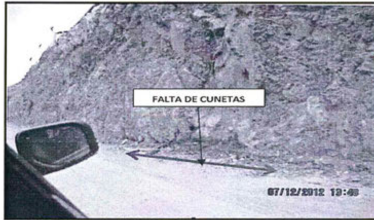
Foto N° 67: Observación N° 01-2012. En la vía de acceso a la planta concentradora, se observó que el titular minero no ha implementado cunetas para la evacuación de las aguas de escorrentía.
