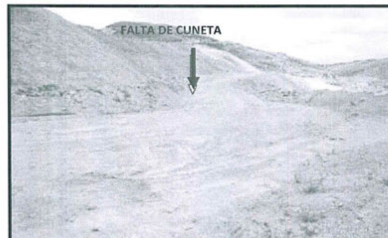
Fotografía N° 21: Vías de acceso en el Stock de Óxidos N° 1, se observa que las vías no cuentan con cunetas de drenaje para escorrentías, Recomendación N° 8, UM Cerro Corona, 2011.
