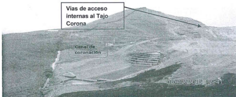
Foto N° 4: Vista del canal de coronación y la poza de sedimentación, al lado del tajo Corona, ubicados en la influencia de la quebrada Corona.
