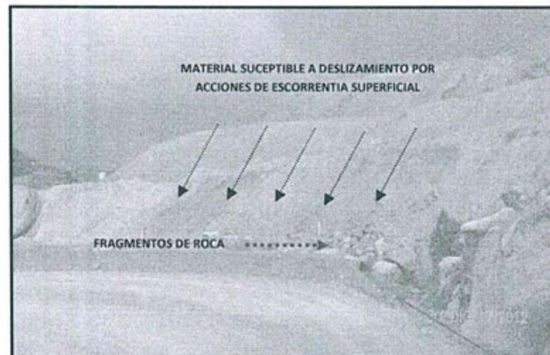
Foto N° 59: Cumplimiento parcial de recomendación N° 8-2011.- Vista del tramo de la vía de acceso al stock de óxidos con cunetas sin mantenimiento adecuado para conducir aguas de escorrentía.
