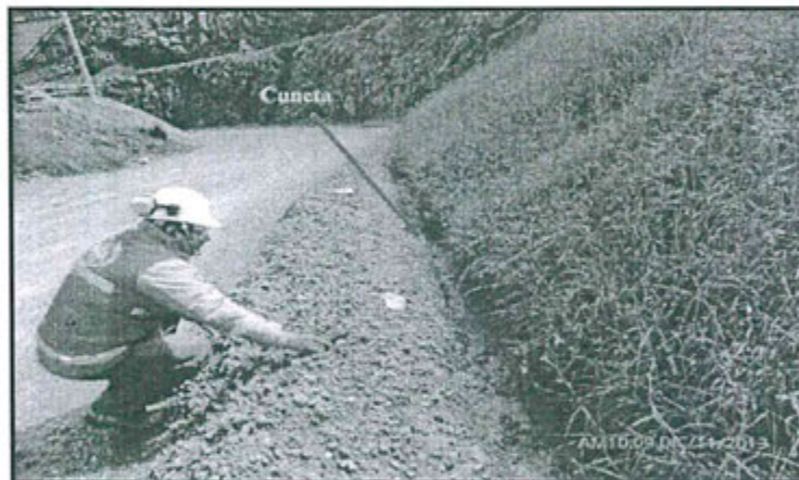
Fotografía N° 8: Vía de acceso hacia la planta concentradora (parte posterior), donde se habilitó una cuneta para la colección de las aguas de escorrentía, la cual se encuentra en buenas condiciones (cumplimiento de la recomendación N° 1-2012).
