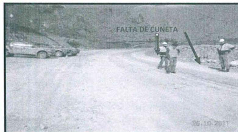
Fotografía N° 20: Vía de acceso Haul Road 3, ubicado al norte del Depósito de Desmontes, no cuenta con cunetas para escorrentías, Recomendación N° 8, UM Cerro Corona, 2011.
