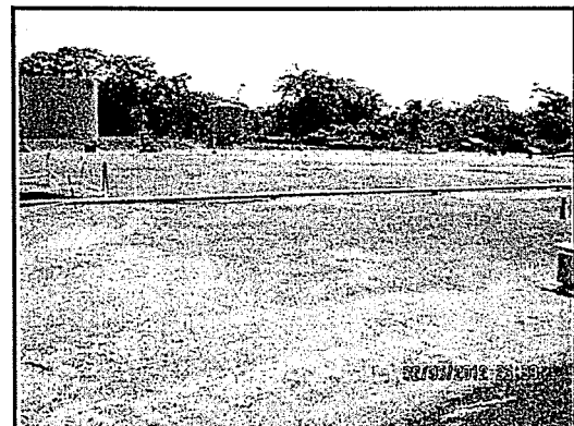
Fotografía N° 8: Amplia vista del área estanca cuyos muros se deterioran por acción erosiva de la vegetación.
