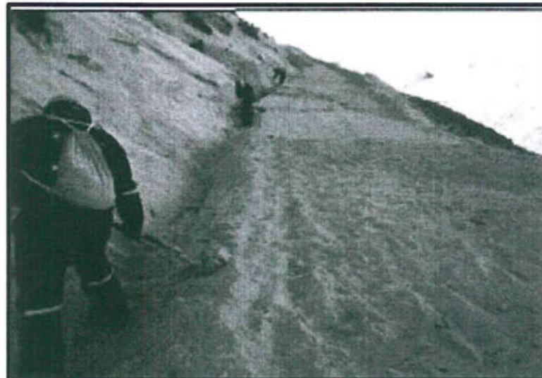
Foto N° 2: Construcción, mejora y mantenimiento de cuentas a lo largo de los accesos en la zona de Yanarico.
