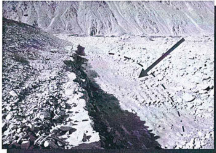
FOTO N° 4: Vista de la zanja, ubicada al oeste de la defensa ribereña, donde se aprecia derrame de relaves.
