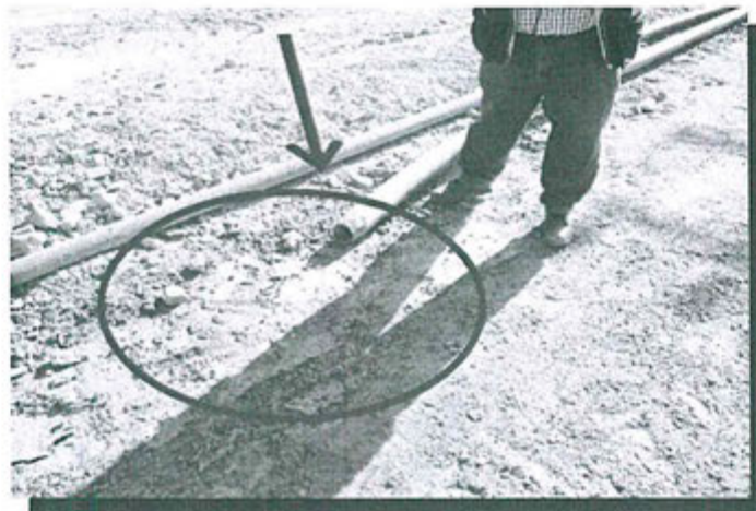
FOTO N° 2: Vista de la tubería de descarga del sifoneo de relaves ubicado en la curva de la defensa ribereña.
