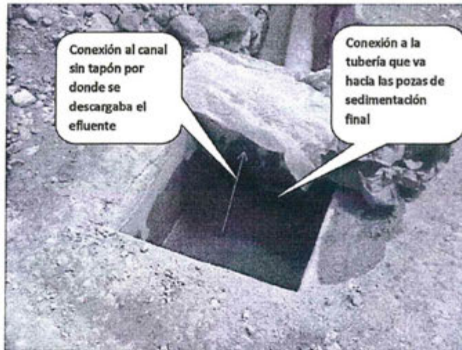
Foto N° 01: Cajón contiguo al punto PM-1 donde conecta la tubería hacia el canal, sin tapón adecuado por donde se conducía el efluente tratado en las pozas del Nv. 00 hacia el río Paratía (Observación N° 1).
