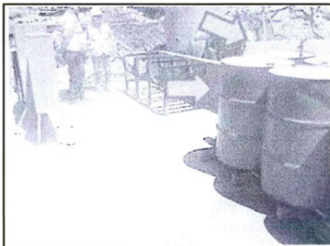
Vista 26. Se observa que la empresa ha colocado muros de contención en dos zonas donde normalmente se colocan los residuos peligrosos. Sin embargo, se observó que estos cilindros estuvieron colocados fuera de la zona que le corresponde.
