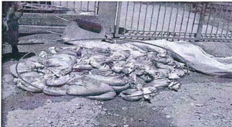
Fotografía 22: No se aplicó un plan adecuado de manipulación del material derramado.
