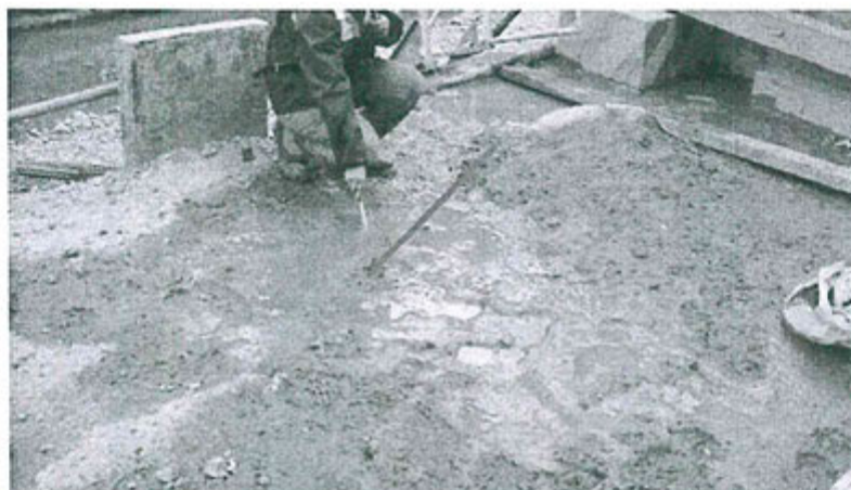
Fotografía 21: Área donde se dispuso las bolsas que almacenaban el material derramado en la ribera y cauce del río Huallaga, (residuos peligrosos), identificándose que no tienen un adecuado manejo y disposición de los residuos sólidos peligrosos, ni de los suelos.
