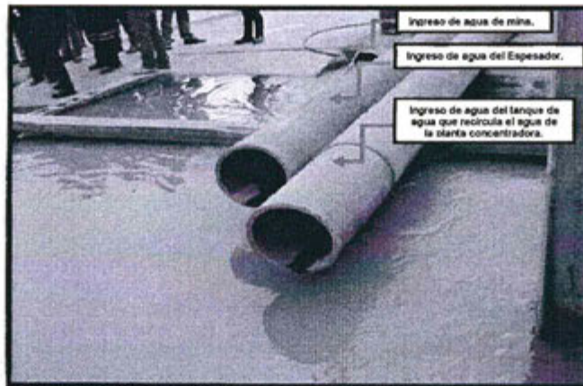
Fotografía N° 07: Poza N° 1 del sistema de sedimentación, vista de las tres tuberías por las que ingresa el agua a este sistema.
