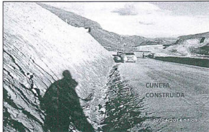
Fotografía N° 10. Vista de las cunetas construidas en el camino minero Tramo 2 del tajo Ferrobamba, estas son objeto de mantenimiento
