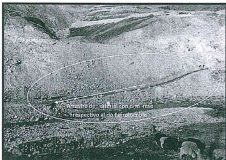
Fotografía N° 33. Hallazgo N° 3. Vista de la parte baja de la zona ingreso a los trabajos que se están realizando para la chancadora, donde se observa que no existen los controles para evitar el arrastre de material al río Ferrobamba, cabe señalar que se observan rastros del arrastre del material.
