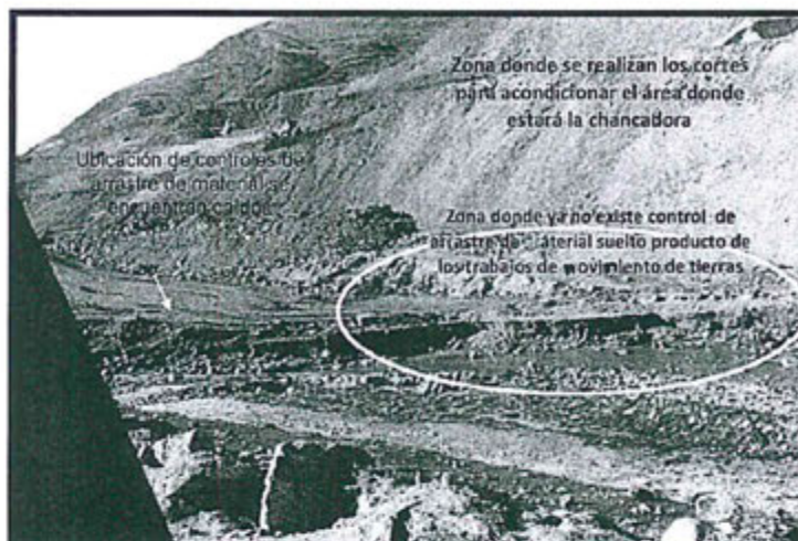
Fotografía N° 32. Hallazgo N° 3. Otra vista de los controles de arrastre de material que se encuentran caídos y más adelante ya no existen.
