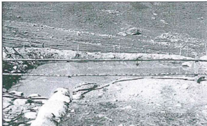
Fotografía N° 8. Se ha levantado la altura perimetral de la poza de sedimentación N° 1.
