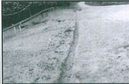
Fotografía N° 19: Canaletas de desvío de agua fluvial.
