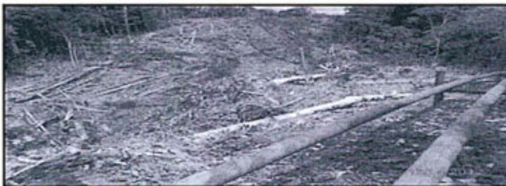
Fotografía N° 24: Vista del Derecho de Vía de Ductos. Obsérvese área deforestada de aproximadamente 80 metros de ancho.
