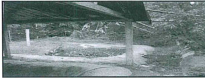
Fotografía N° 56: el relleno sanitario no cuenta con planta de tratamiento de lixiviados, pozos de monitoreo de aguas subterráneas, sistemas de monitoreo control de gases y lixiviados. Las chimeneas de evacuación de gases no son adecuados.
