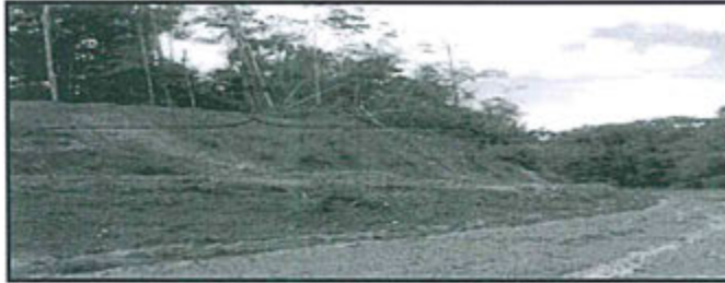
Fotografía N° 7: Vista de la ladera del camino hacia la Plataforma 1301, obsérvese el deslizamiento y erosión de suelos. Fotografía tomada de otro ángulo.
