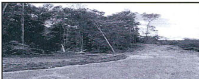
Fotografía N° 6: Vista del deslizamiento y erosión de la vía o camino de ingreso a la Plataforma N° 1301.
