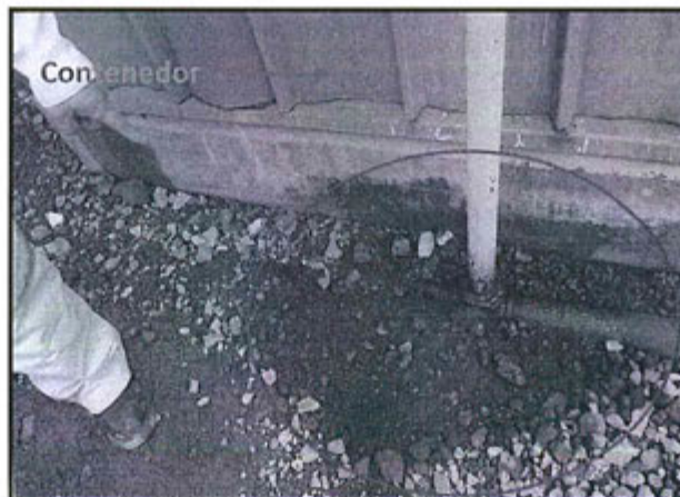
Fotografía N° 44: Fuga de hidrocarburos en la línea de conducción de petróleo hacia los grupos electrógenos. Hallazgo N° 14 – Supervisión Ambiental 2013.
