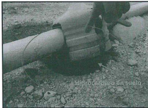
Fotografía N° 46: Fuga de hidrocarburos en la línea de conducción de petróleo hacia los grupos electrógenos. Hallazgo N° 14 – Supervisión Ambiental 2013.
