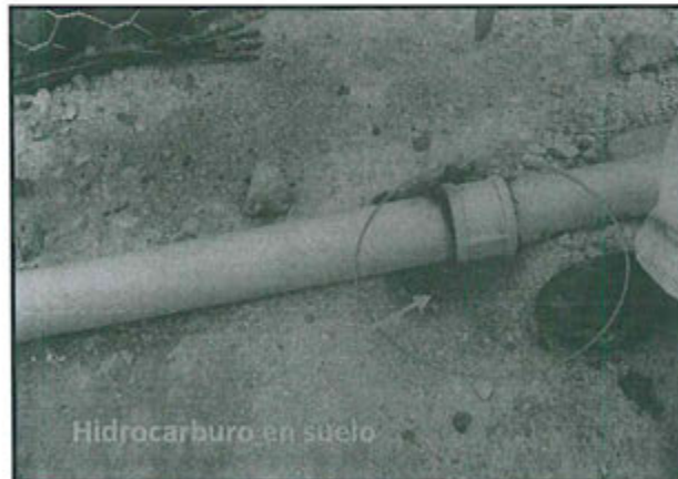
Fotografía N° 47: Fuga de hidrocarburos en la línea de conducción de petróleo hacia grupos electrógenos. Hallazgo N° 14 – Supervisión Ambiental 2013.
