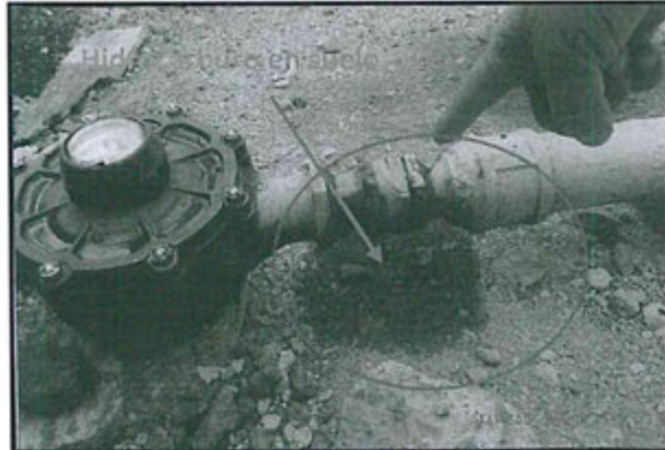
Fotografía N° 45: Fuga de hidrocarburos en la línea de conducción de petróleo hacia los grupos electrógenos. Hallazgo N° 14 – Supervisión Ambiental 2013.
