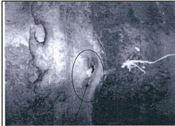
Foto N° 2: Muestra la ROTURA en el ducto, ocasionado por una sobrepresión, debido a que la Motobomba N° 03 de Trompeteros no Contaba con un sistema de protección por ALTA presión.
