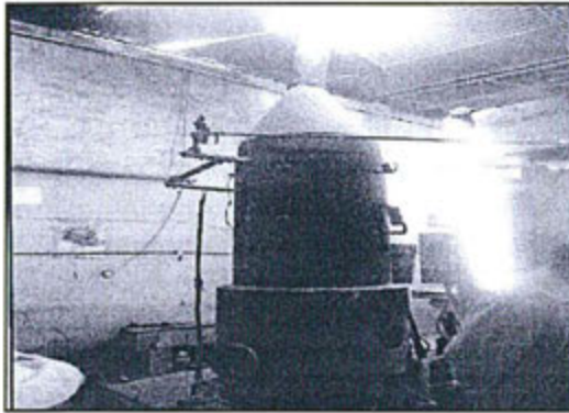
Foto N° 6: Vista de uno de los calderos que tiene una capacidad de 2 Toneladas de agua, según manifestación del administrado.
