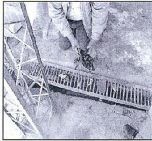
Foto N° 15: Vista de las canaletas por donde discurren los efluentes industriales, con acumulación de residuos sólidos muy gruesos y falta de mantenimiento de las mismas.
