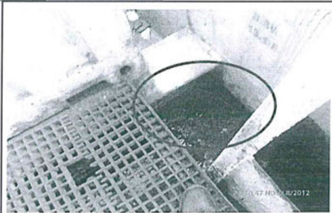
Fotografía N° 34: Muestra planchas deterioradas con signos de corrosión severa, y material aceitoso que luego es arrastrado al mar a través de las ventanas sin tratamiento alguno.
