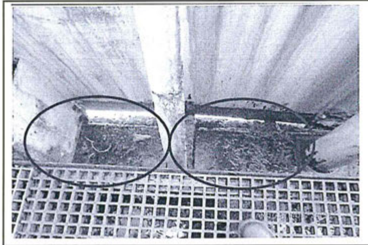
Fotografía N° 31: Muestra ventana y planchas deterioradas con signos de corrosión severa, a través del cual se eliminan al mar las aguas oleosas que se generan debajo de los compresores.
