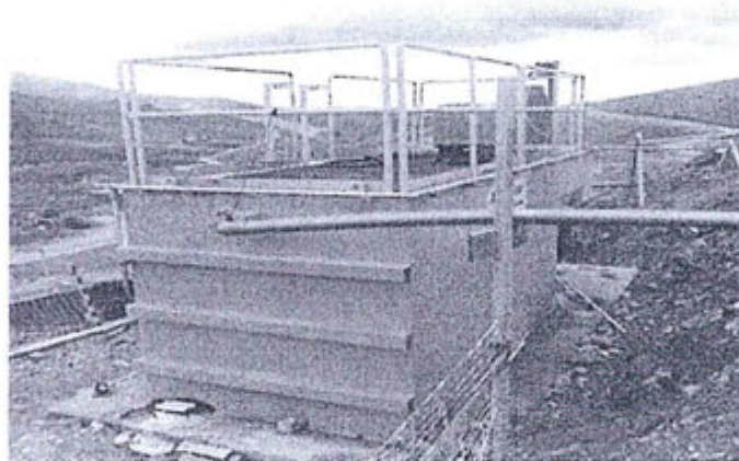
Fotografía N° 2.- Planta de Tratamiento de Agua Residual Doméstica –Agani
