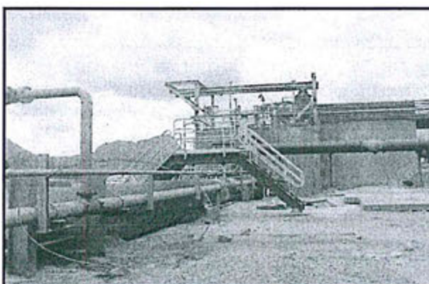
Foto 32: Verificación de otro de los lados de la línea de tubería Norte donde aún se presenta derrame de relaves evidenciando que la tubería de aireación requiere medidas de control (Cumplimiento parcial de la recomendación N° 8 del 2011).
