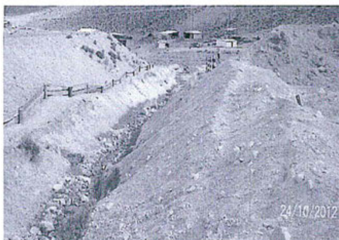
Foto N° 64.- Observación N° 3, Depósito de Topsoil ubicado en la margen izquierda de la vía de acceso al NV 4720. Falta mantenimiento y completar el cerco perimetral.
