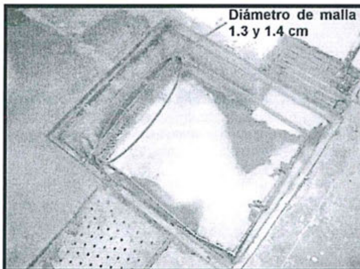
Fotografía 3: Vista de la trampa de sólidos
