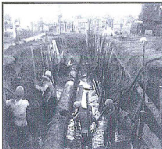
Fotografía N° 1.- Desentierro de la Tubería de 24" de diámetro de la Estación 1 – Saramuro del Oleoducto Norperuano.
