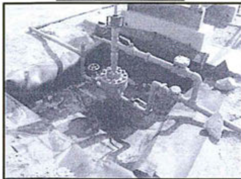
Fotografía N° 28 del Anexo 2 de los descargos (Pozo 1606) 27
