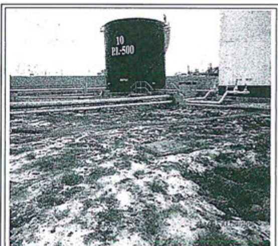
Fotografía N° 4: área estanca de los tanques de Almacenamiento (Zona Baja), muestra suelo NO impermeabilizado, se observa porciones de sal sólida cristalizada, además suelo húmedo, por presencia de napa freática superficial.
