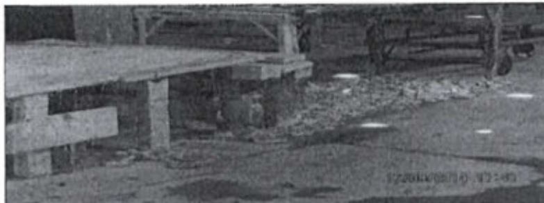
FOTOGRAFÍA N° 12: Residuos de descarnado acumulados sobre piso de cemento, al costado de máquina descarnadora
