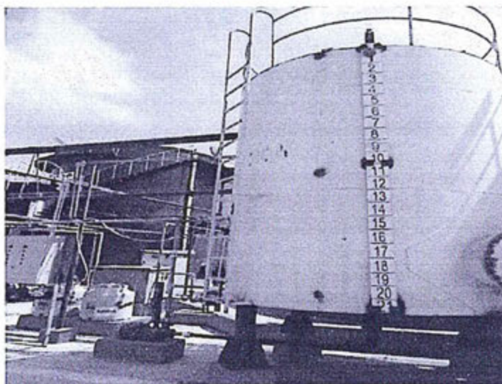
Foto N° 26 -Tanque de neutralización con capacidad de 21 m 3 .
