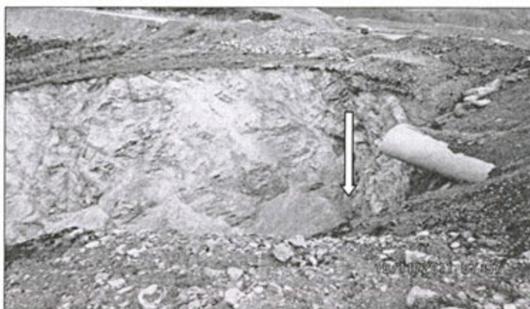
Foto N° 8.- Observación N° 2. Supervisión 2011. Tubería de descarga de las aguas de escorrentía del canal de coronación de los PAD de lixiviación a la quebrada Tres Cruces, en las coordenadas WGS- 84 E 820 691 N 9 116 592. Nótese la altura (aprox. 20 m.) y la fuerte erosión ocasionada.
