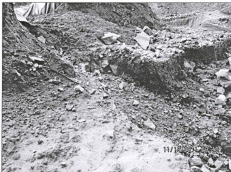
Fotografía N° 6: Observación N° 2 Supervisión 2011: Cárcava, ubicado al costado de la poza de sedimentación que capta las aguas del canal de coronación de los PADs de lixiviación (coordenadas UTM WGS-84 E: 820 799 N: 9 116 510). La poza de sedimentación no se observa porque se encuentra en la parte superior izquierda la vista fotográfica (en la foto N° 5 se observa la poza de sedimentación).
