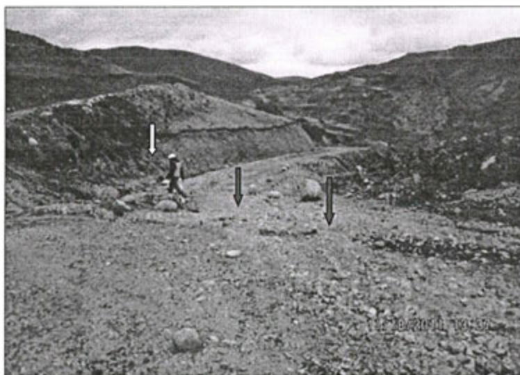
Foto N° 19.- Observación N° 7. Supervisión 2011. Se observó erosión hidráulica (flechas en rojo), del canal de coronación del tajo Suro Norte (flecha en blanco), que se encuentra interrumpido en esta zona.
