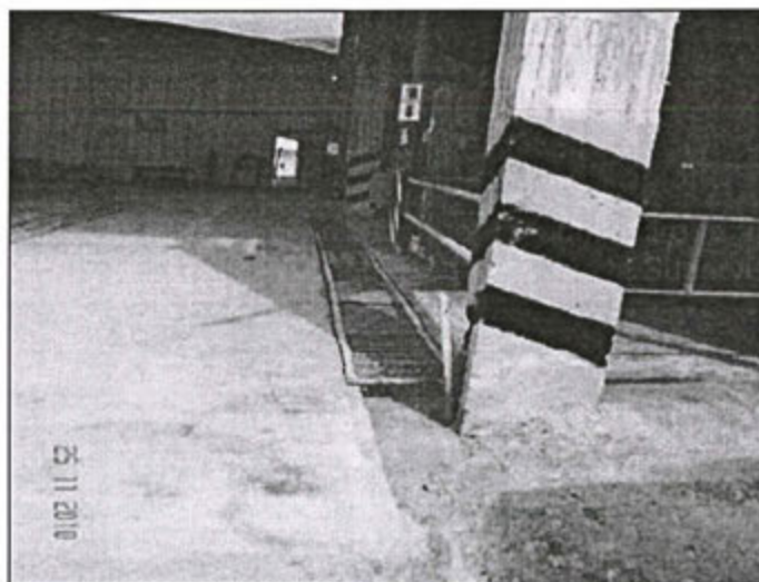
Foto 2.10 Obs. 8. En el taller de mantenimiento existen canaletas sobre piso de concreto con salida directa al ambiente (suelo natural).
