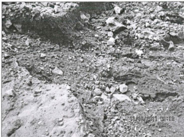
Fotografía N° 7: Observación N° 2. Supervisión 2011. Otra vista de la cárcava, ubicado al costado de la poza de sedimentación que capta las aguas del canal de coronación de los PAD de lixiviación (coordenadas UTM WGS-84 E: 820 799 N: 9 116 510). La poza de sedimentación no se observa porque se encuentra en la parte superior izquierda la vista fotográfica (en la foto N° 5 se observa la poza de sedimentación).
