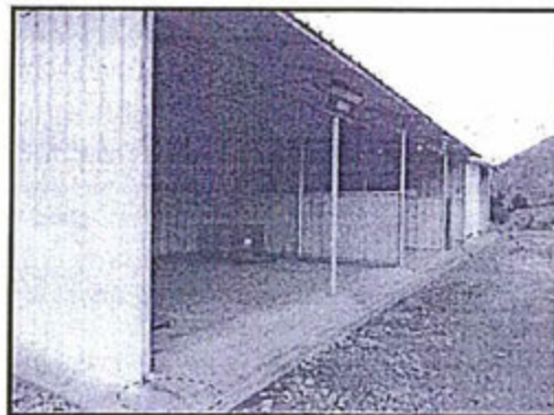
"Foto N° 20: Vista fotográfica del área 2 del almacenamiento central de residuos sólidos, ubicada en el exterior de la planta industrial, donde se observa canaletas de concreto seccionadas"
