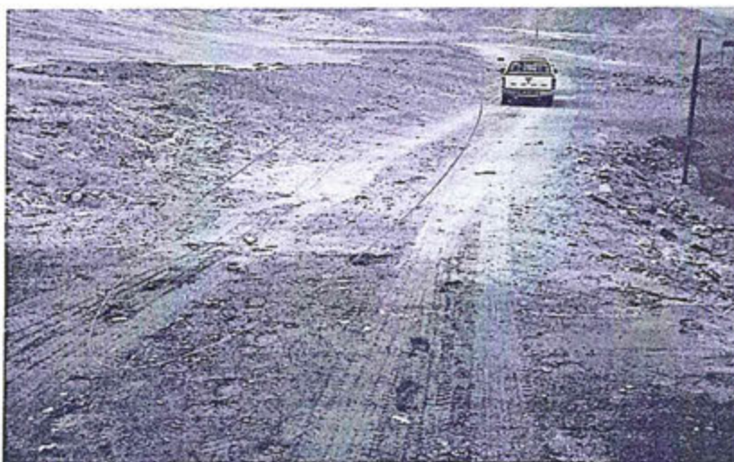
Foto N° 78: El talud del depósito de relaves N° 3 no cuenta con un muro de contención que permita un mejor manejo operativo de la disposición de relaves: la empresa deberá construir un muro de contención Recomendación N° 1-2011.
