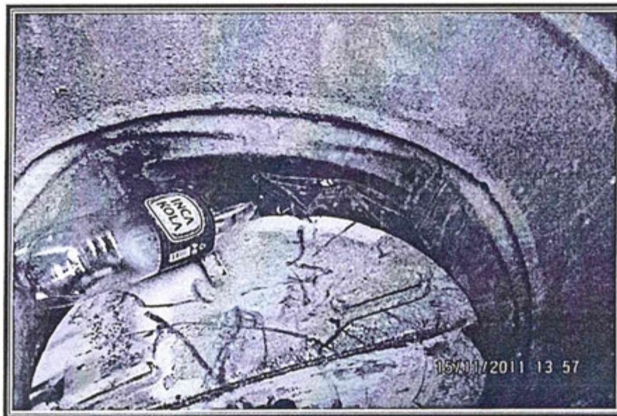
FOTOGRAFÍA N° 57.- Observación N° 08: Vista fotográfica del interior del cilindro amarillo (para la disposición de residuos metálicos) instalado en zona Bateas (coordenada UTM WGS 84: 8'319,578N; 192,349E y 4539 msnm). Se aprecian otros residuos (botellas de plásticos y mica de plástico) que no corresponden al tipo indicado.
